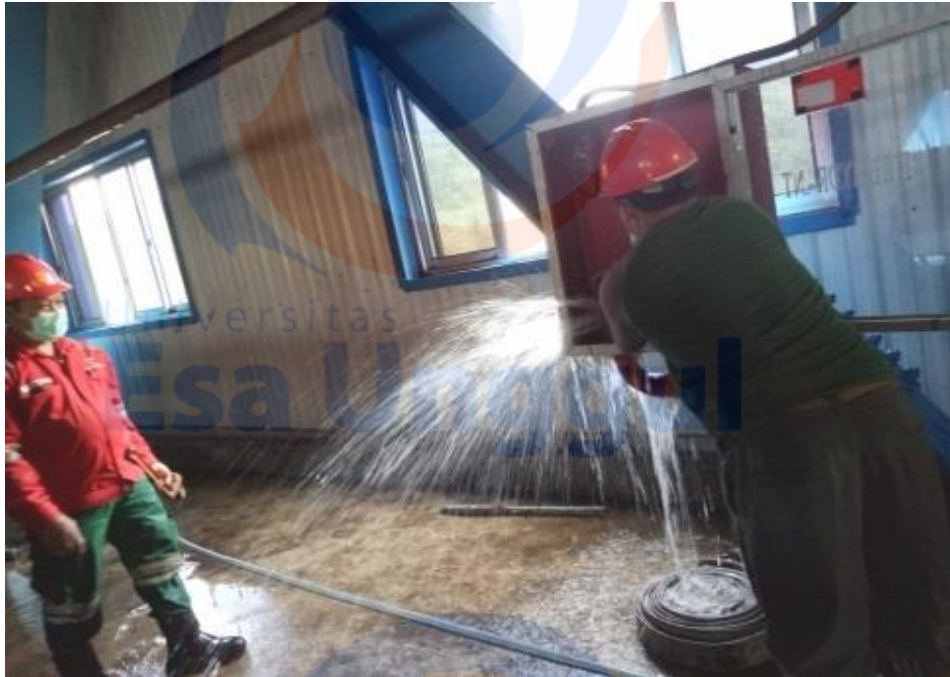
Gambar 2.4. Penanganan oleh tim K3 pada hydrant yang bocor akibat penutup valve yang pecah di area Belt Conveyor 6 .
