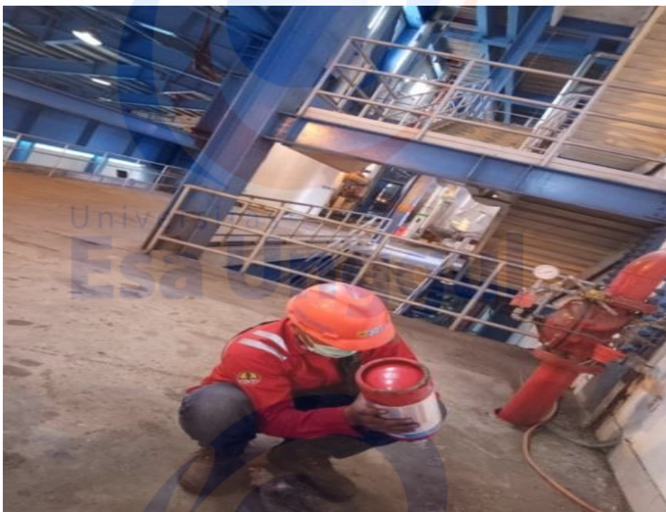
Gambar 2.10 dan 2.11. Proses pengecekan dan pembersihan APAR dengan menggunakan identitas pekerja K3 di area Turbin House yang nantinya data akan langsung masuk ke monitoring perusahaan.
