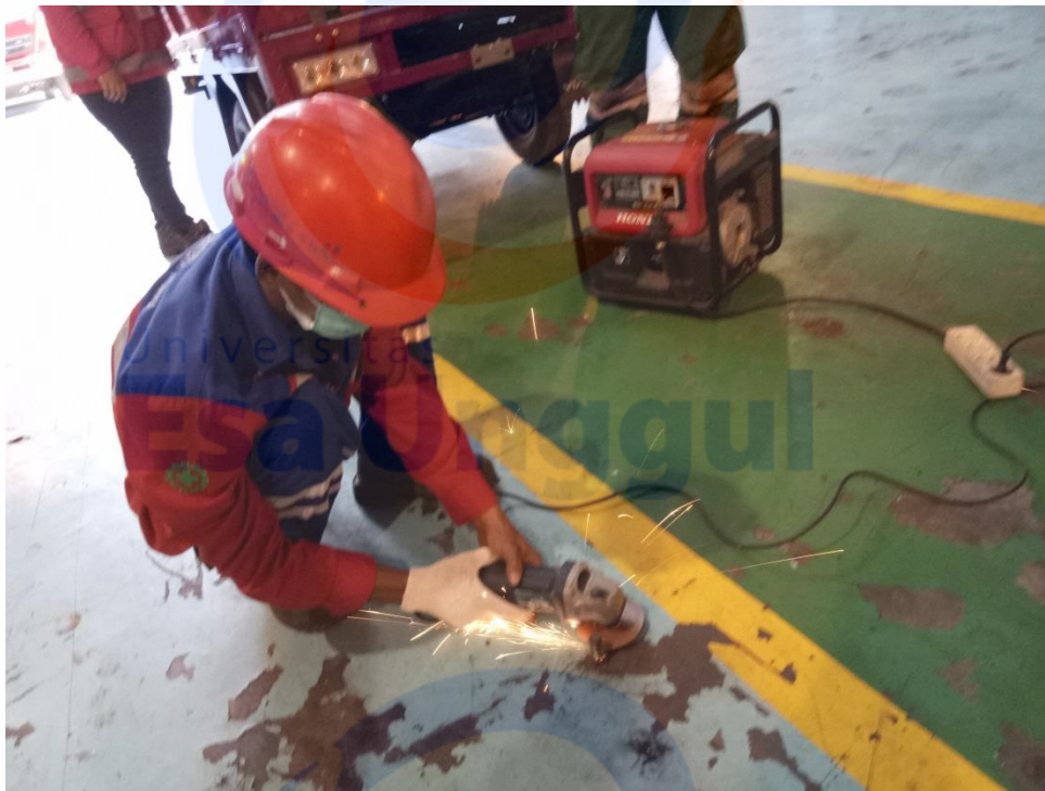
Gambar 2.18. Proses pemotongan baut yang menjadi penemuan unsafe condition saat sedang patrol rutin di area Turbin House .
