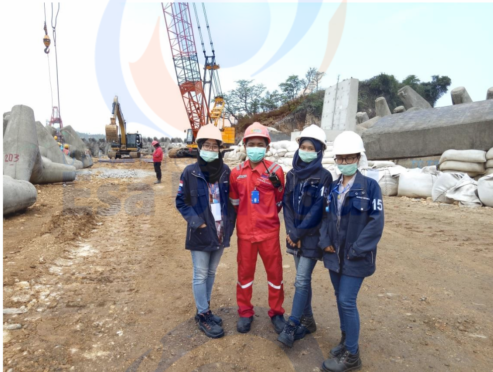
Gambar 2.16. Melakukan pengawasan terhadap kegiatan pengangkutan batu pemecah ombak di area Temporary Jetty .
